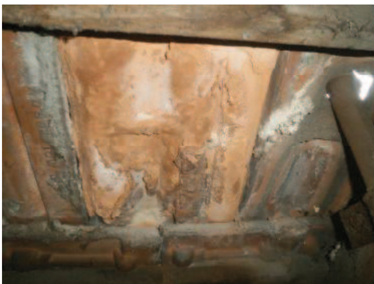
Tašky jsou ve špatném stavu
