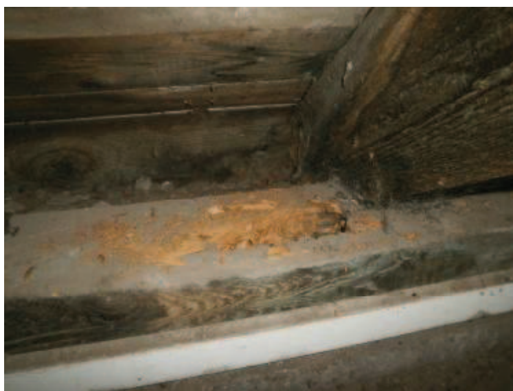
Pozednice mezi krovemi K58 a K59 poškozená dřevomorkou domácí
