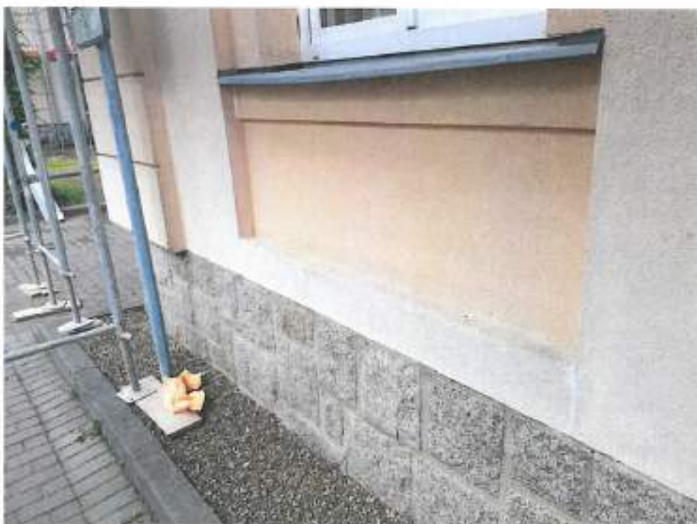
Obr.2: Budova 2 – stávající napojení zateplené stěny bez systémové okapnice a bez oplechování
