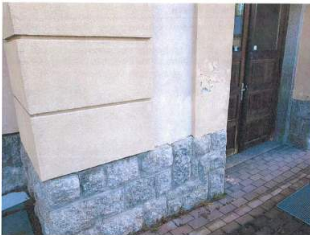
Obr.3: Budova 3 – stávající napojení bez systémové okapnice a bez oplechování
