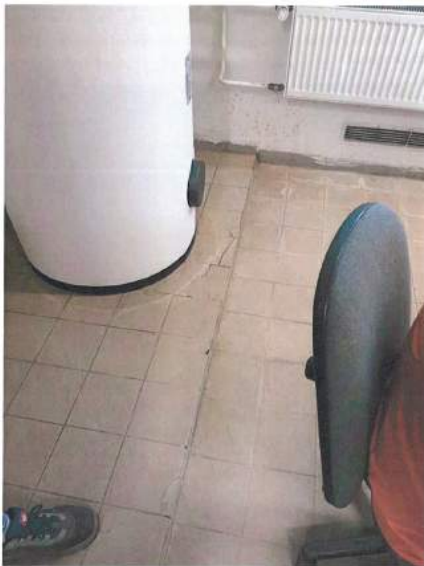
Obr.5: Stávající popraskaná dlažba v místnosti 01.08
