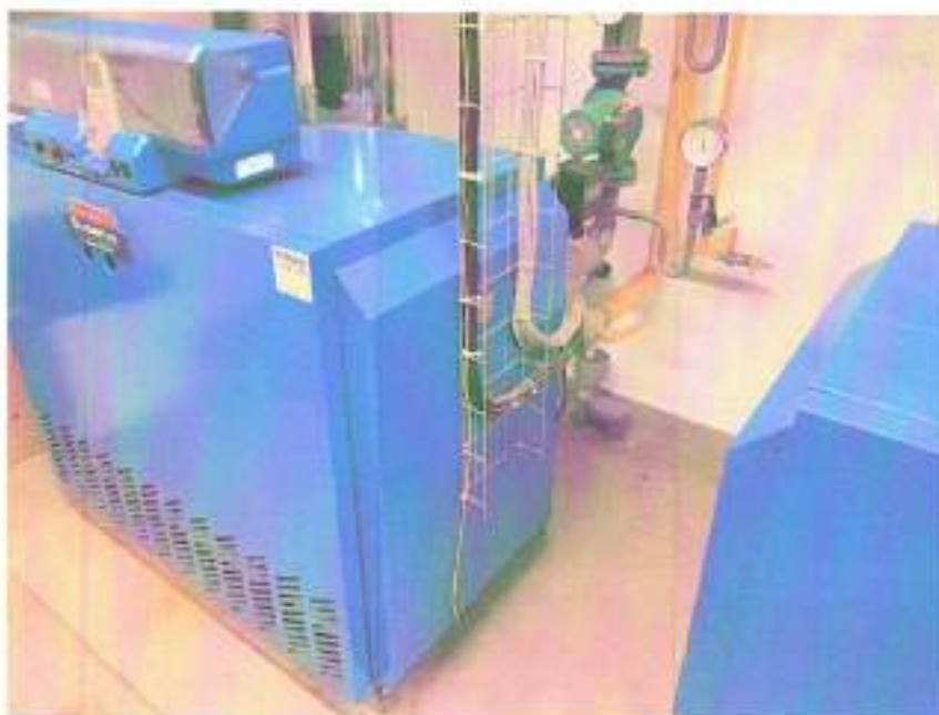
Obr.1: Budova č.2: Instalace v kotelně
