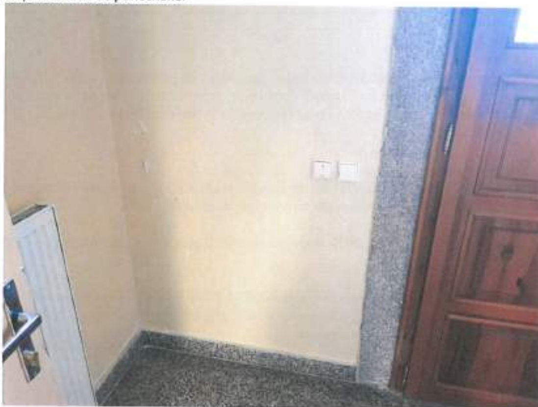
Obr.1: Vlhkostní projevy v zádveří
