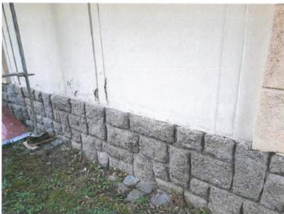
Obr.1: Budova 2A – stávající napojení nezateplené stěny a soklu bez oplechování
