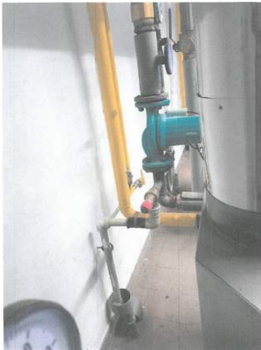
Obr.2: Budova č.2: Instalace v kotelně u stěny
