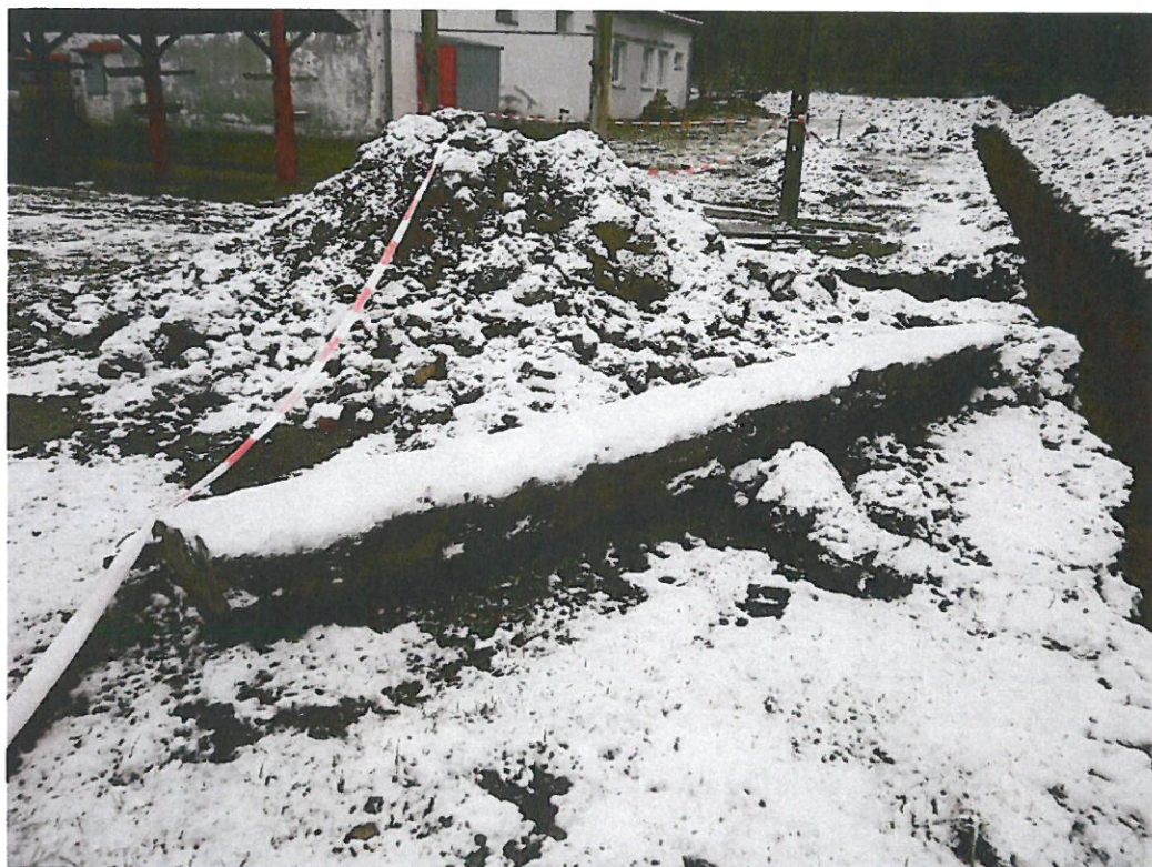
foto č. 2 – pohled na vykpané staré betonový pas
