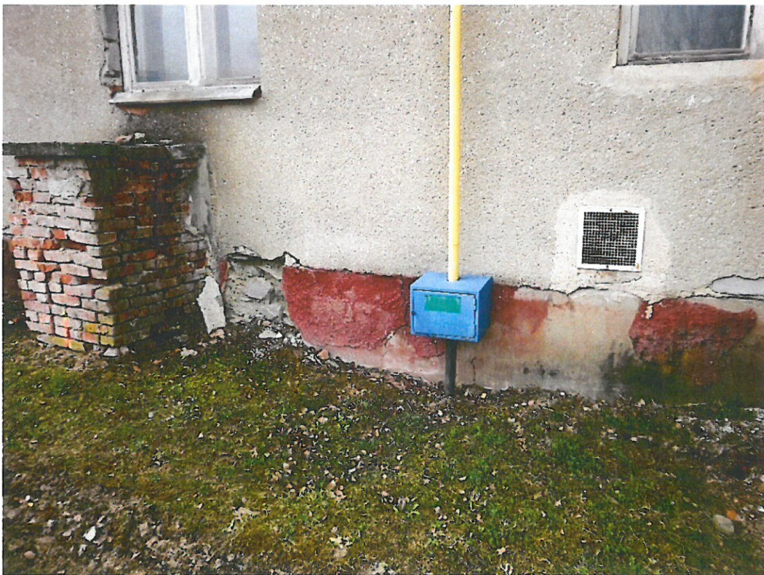
foto č. 1 – pohled na stávající skříňku HUP
