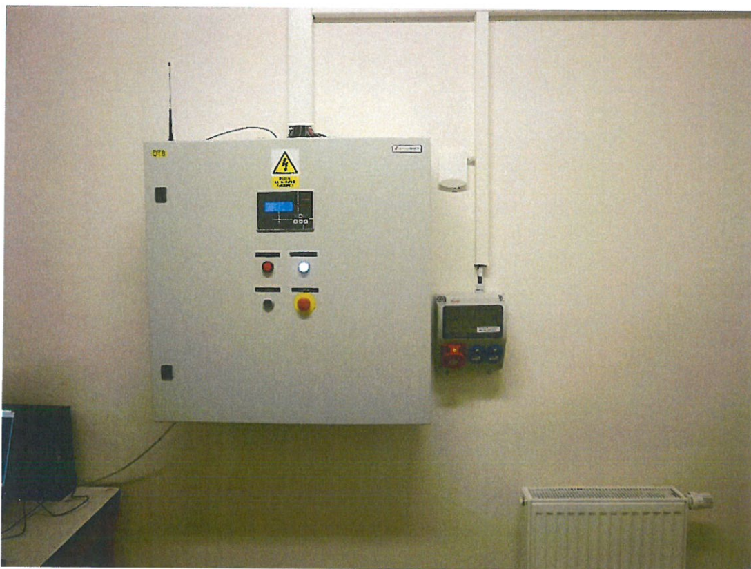
foto č. 1 – pohled na řádkový displej v rozvaděči
