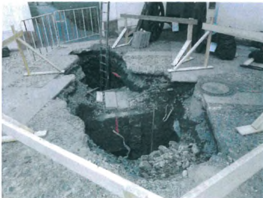
Obrázek 2-Teplovodní kanál v kolizi s nově budovanou kanalizací
